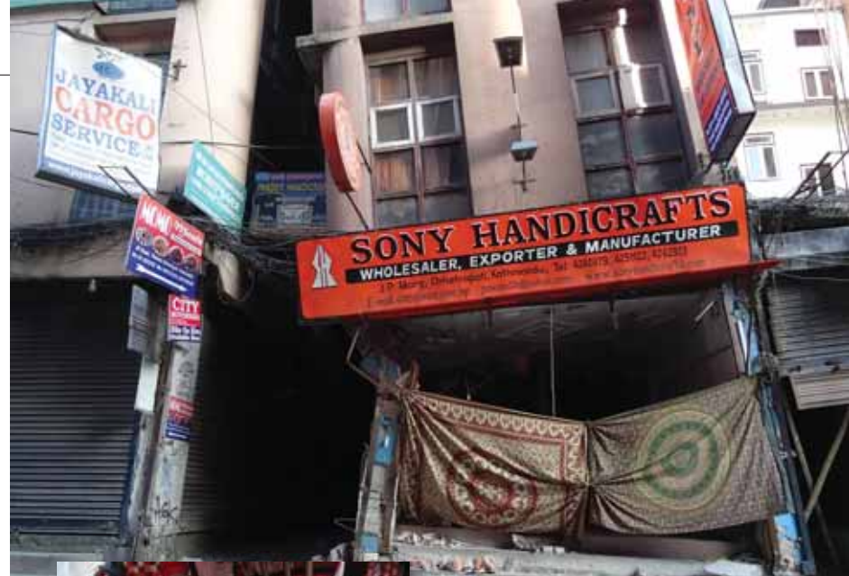
Budova v Thamele (Káthmandu) poškodená zemetrasením.
